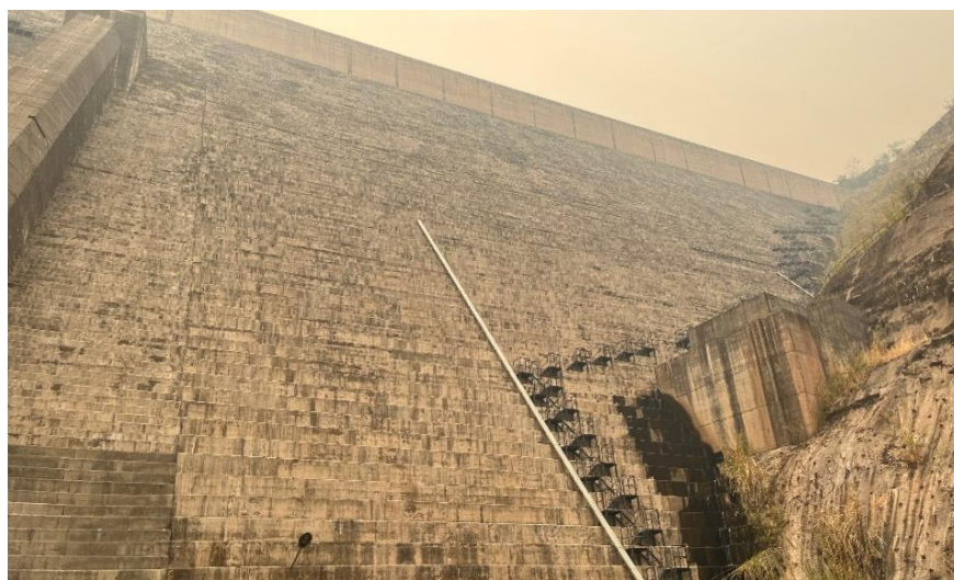
図 7-10 ダム堤体左岸側の下流面の漏水状況（2023. 3 撮影）
