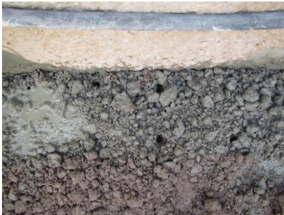
(3) グラウト注入後(注入不足)
