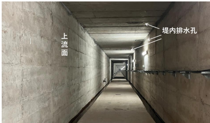
図 7-9 堤内排水孔（中間水平監査廊）の漏水状況（2023. 3 撮影）
