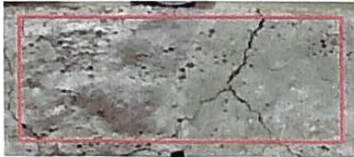
ASRひび割れの様子 (赤枠は画像解析の対象範囲)
