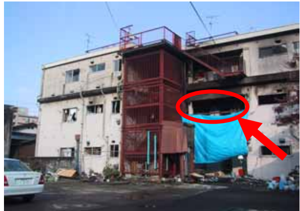
図10 同廊下側,2階廊下のガス配管破損(火元)
