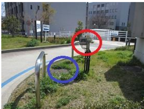
図 1 研究棟に設置された pH 計 青丸：pH 電極（マンホール内） 赤丸：モニター
