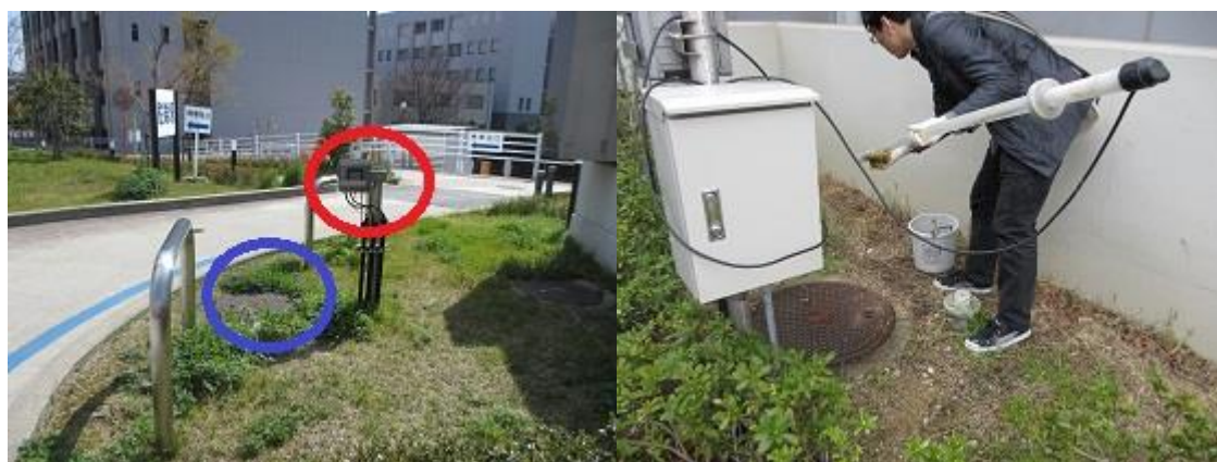
図1 研究棟に設置された pH 計 青丸：pH 電極（マンホール内） 赤丸：モニター
