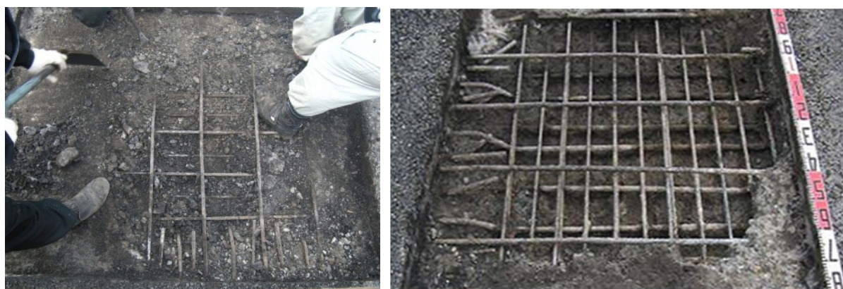
写真 1.2 RC 床版の土砂化
