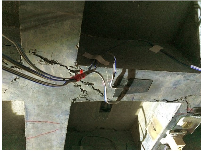
写真 4.2 床版下面のひび割れ状況
