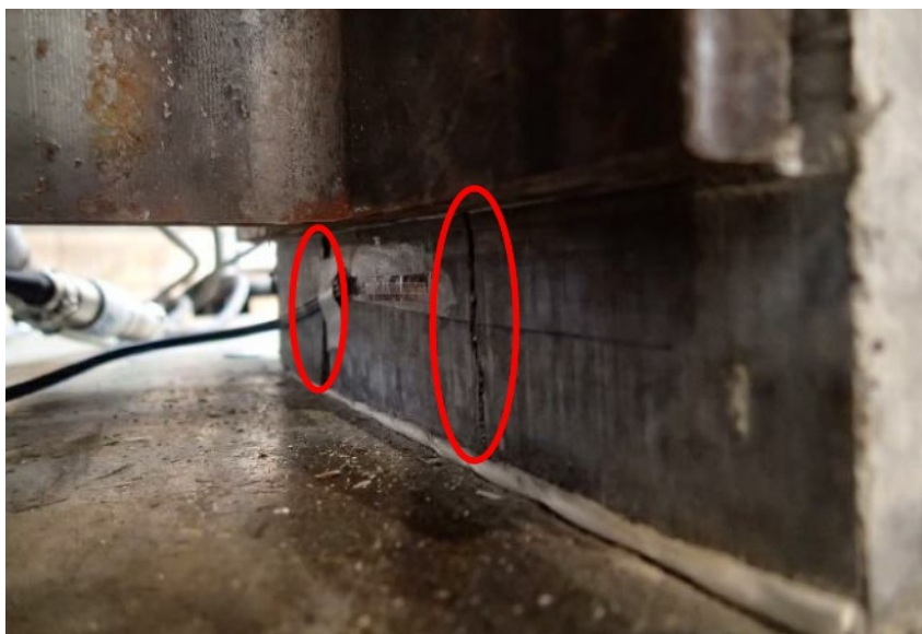
写真 6.4 間詰め部のひび割れ（載荷終了後）
