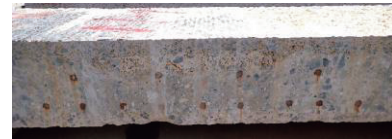
図-3 床版 N-1 ひび割れの様子
