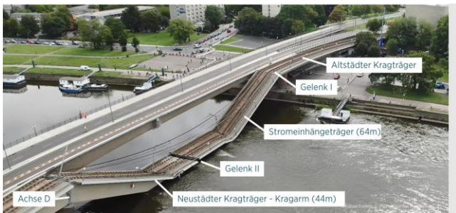
写真-1 崩壊後のカローラ橋 1)
