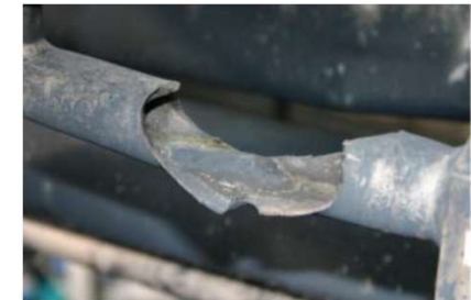
配管の圧力計取付部の破損状況
