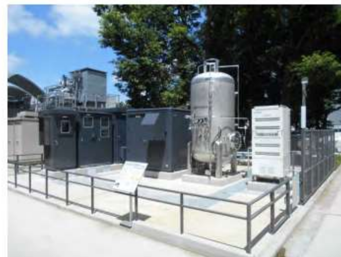
東京都 事業所向け再生可能エネルギー由来水素活用設備導入促進事業
