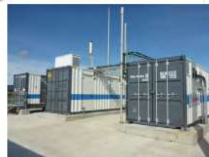
奥より電源装置、水電解装置、ガス圧縮機
