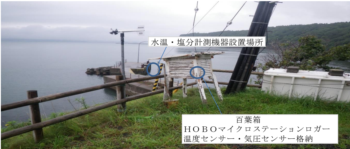
気象観測機器設置場所
