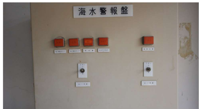
図1. 海水ポンプ警報盤
