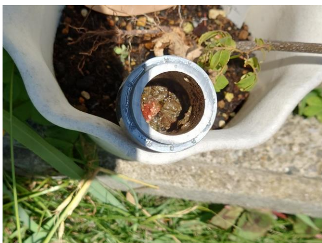
図2 詰まった配管内部
