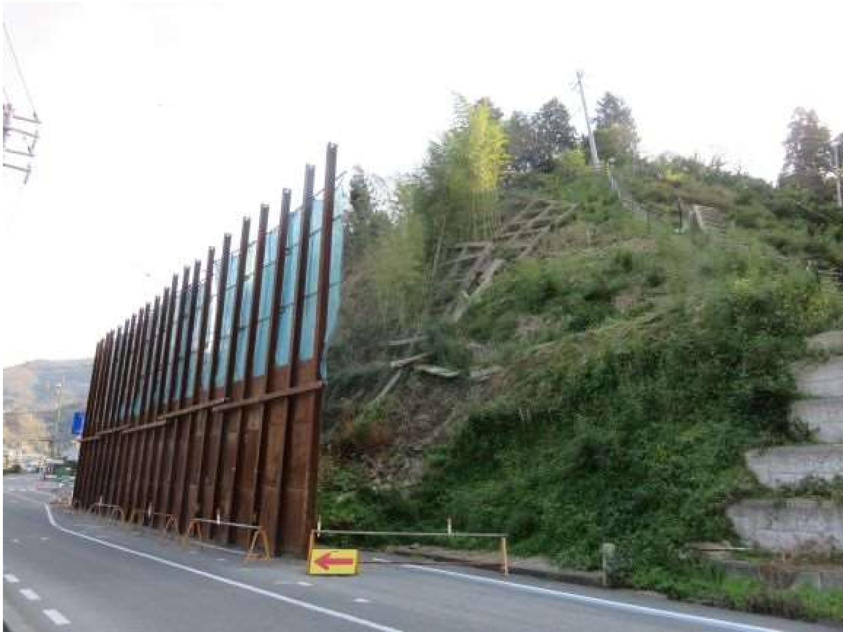
平成30（2018）年7月豪雨による斜面崩壊・広島県下蒲刈島
